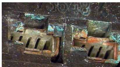
Giunto di accoppiamento con tracce di umidità e corrosione
